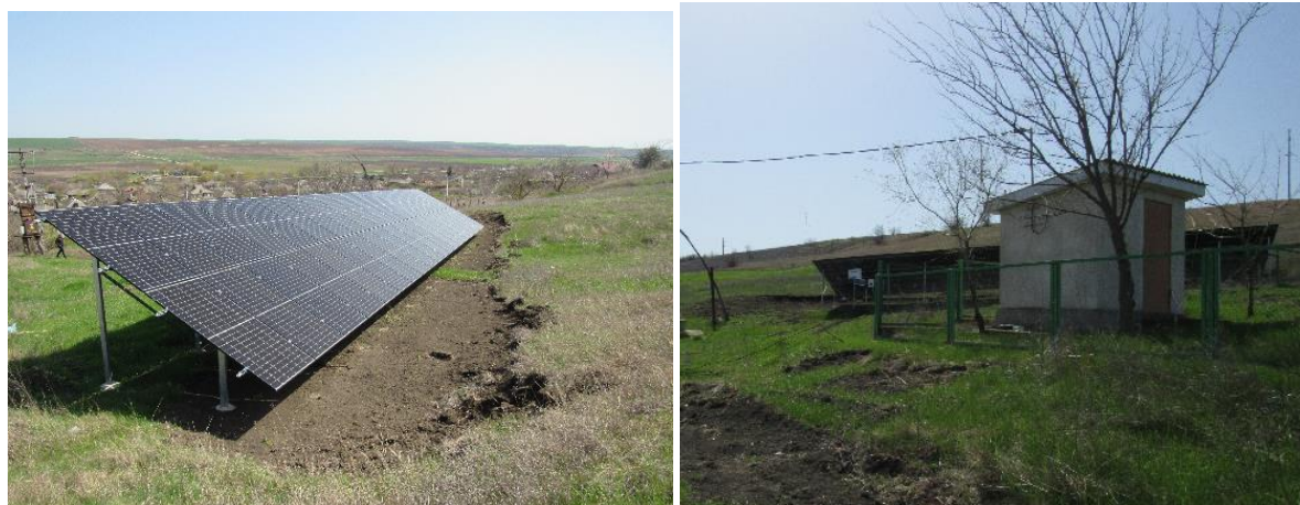
Figura 13. Statia panouri PV la fântina arteziană a localității 65 kW
